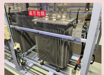
変圧器改修後
